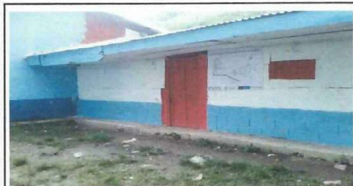
Foto 3: Vista de establecimiento donde se observa necesidad de mejorar las paredes.
