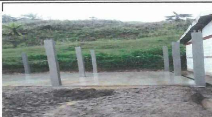
Foto1: Vista de columnas del aula necesita mejorar el corredor.
